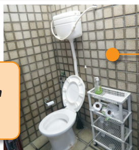
Banheiro interditado é um dos problemas do local
